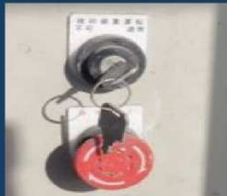
インターロック鍵の抜き取り
