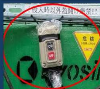
非常用停止装置設置例
