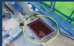
上槽ミキサー上蓋転落防止網
